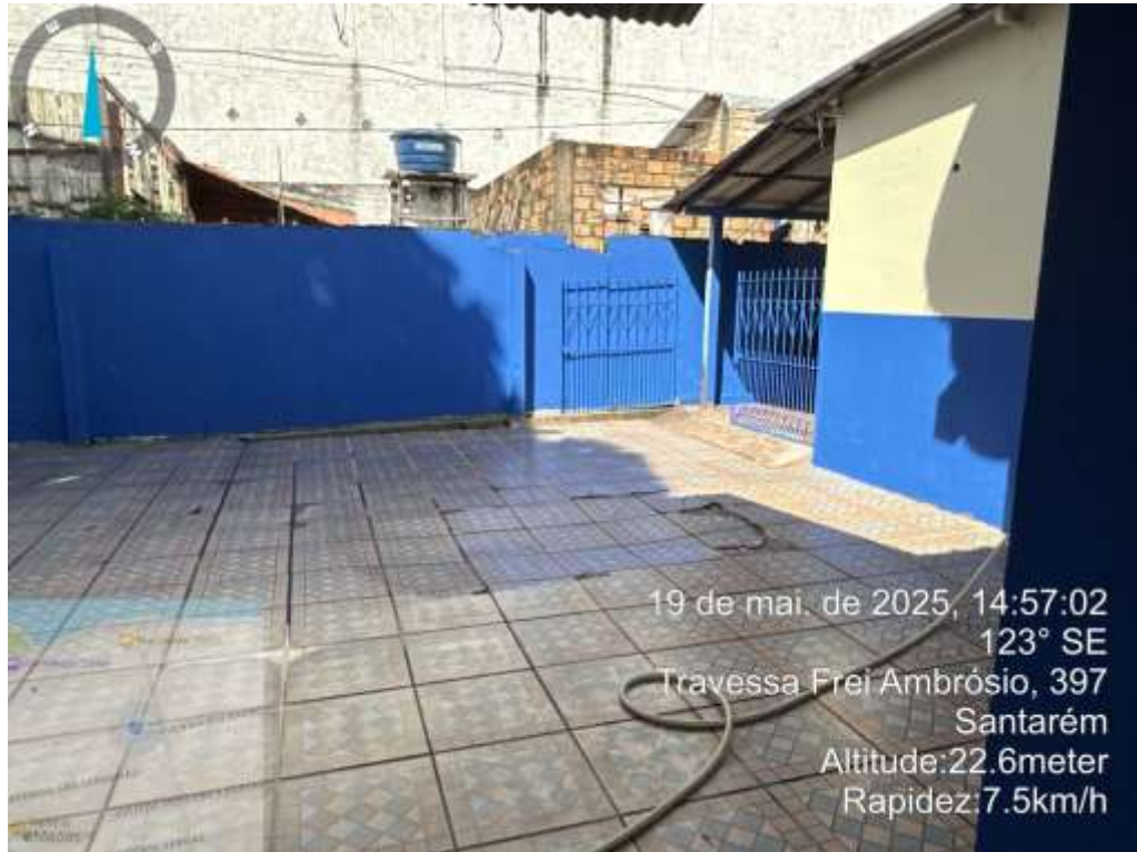
Foto 26: área externa com afundamento
