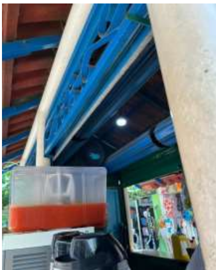
ESTRUTURA DA JANELA DE ROLO
