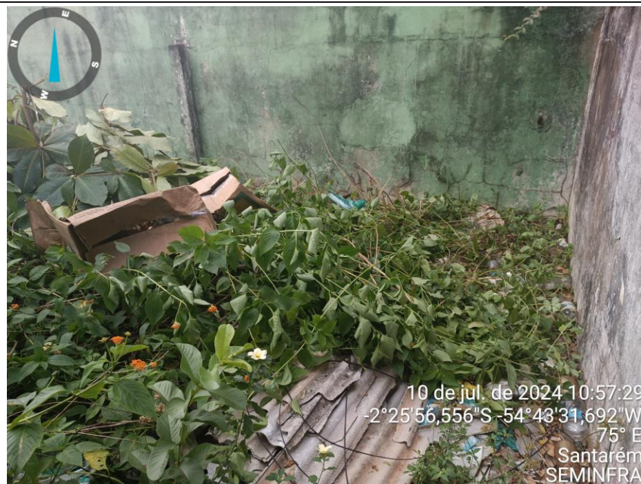
Foto 14: Área Interna do local de obra. Há bastante lixo nos arredores do muro.
